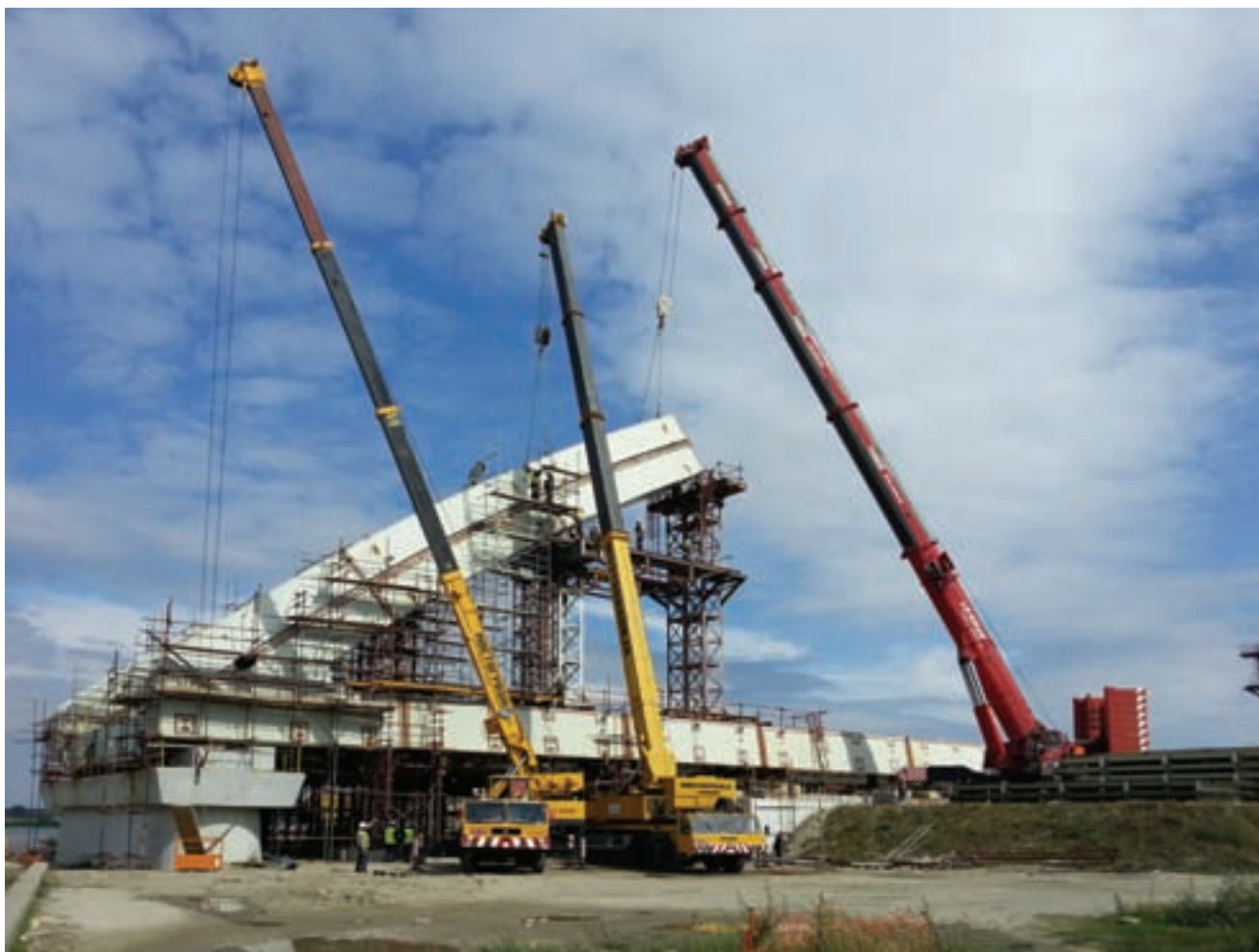
Najznačajniji projekat mostovskih konstrukcija u Evropi danas - Izgradnja "Žeželjevog mosta" u Novom Sadu Ukupnjavanje čelične konstrukcije luka raspona 180 m na desnoj obali Dunava, montaža elementa luka mase 60 t – radove izvodi Mostogradnja
