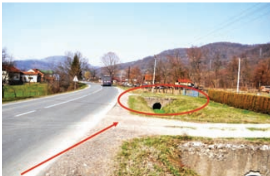
Slika 5 – Provjera bezbjednosti postojećih puteva-problematični betonski propusti u slučaju slijetanja vozila sa puta
