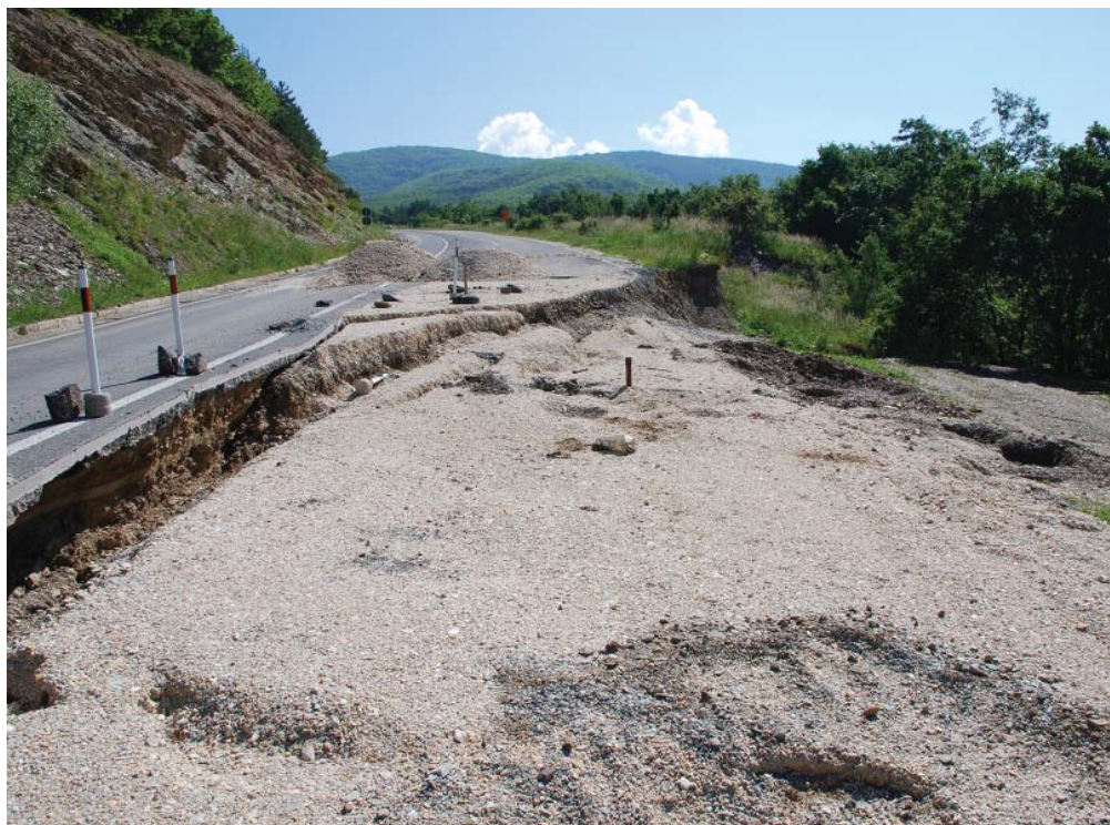
Slika 2. Oštećeni deo puta M-5
