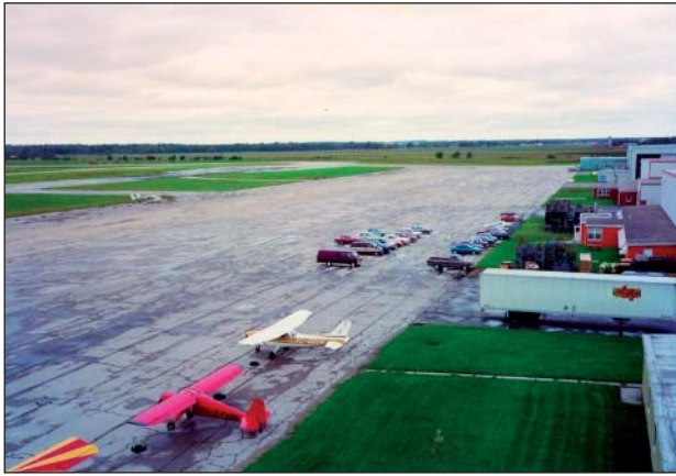
Stanje kolovoza pre obnove, 1992, bezbednosno ugrožen
