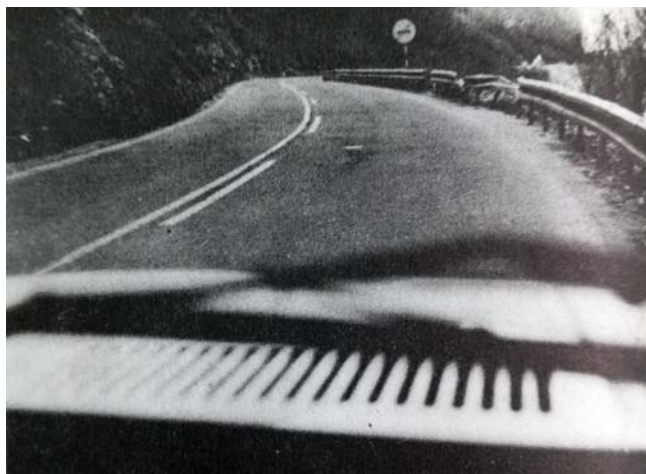
Sl. 4 – Oštećena ograda pored Lima
