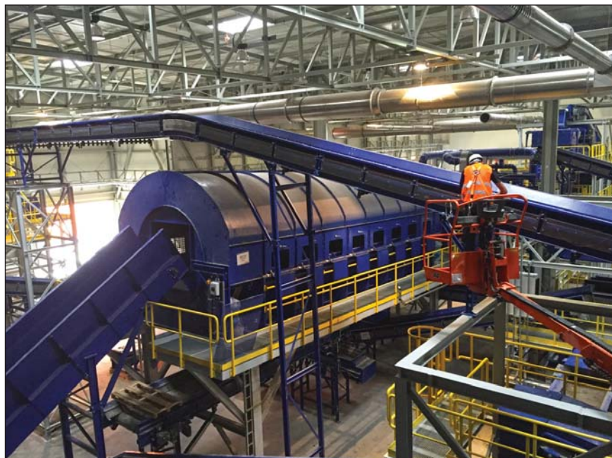
Oprema u centru za upravljanje otpadom
