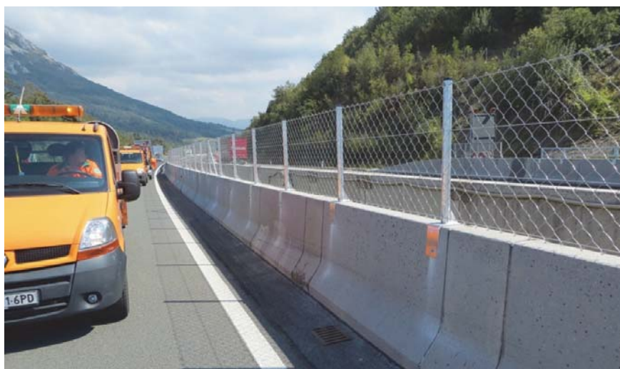
Slika 4. Mjere za sprječavanje skakanja preko betonske zaštitne ograde
