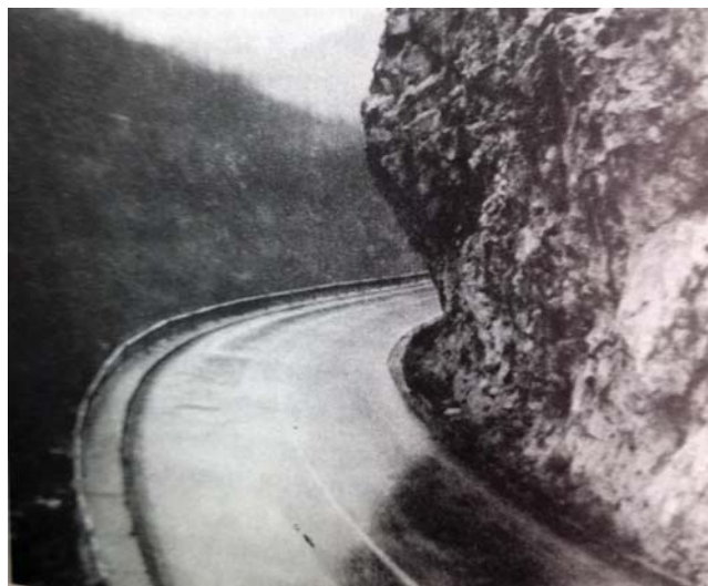
Sl. 1 – Neobezbeđene kosine useka u Ovčarsko-kablarskoj klisuri
