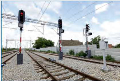
Signalni uređaji za železnicu
