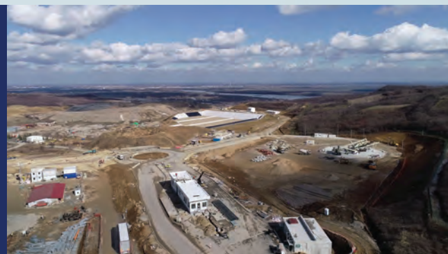
Projekat: Deponija Vinča sa postrojenjem za proizvodnju energije iz otpada Usluga: Izvođenje radova na novoj deponiji i sanaciji stare Beo Čista energija d.o.o. Investitor:
