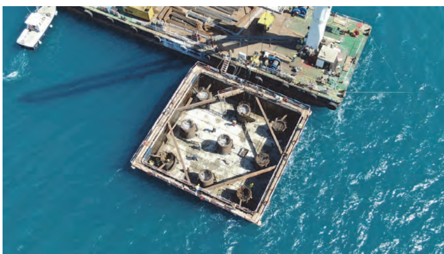
Pogled iz zraka na oplatu jedne naglavnice pilota mosta Pelješac, prije postavljanja armature i betoniranja. Radi se o temelju stupa bliže obali, budući da se oslanja na samo 9 pilota. Središnji se stupovi oslanjaju na 20 pilota.
