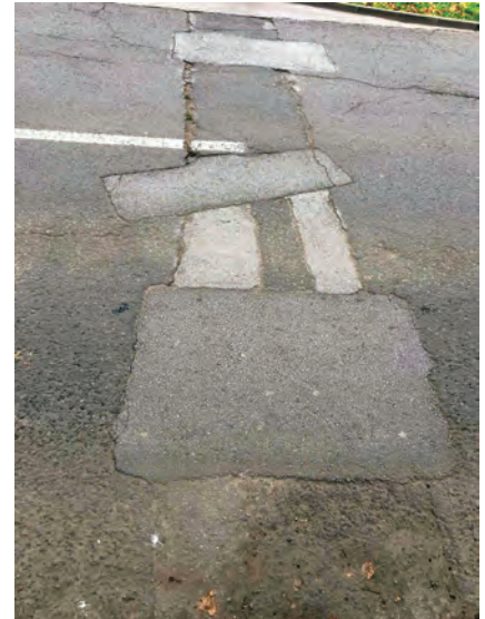
Sl. 3 Zakrpa kao jedno od oštećenja
