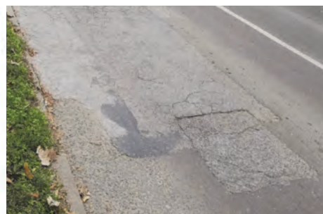
Sl. 6 Prikaz oštećenja saobraćajnice
