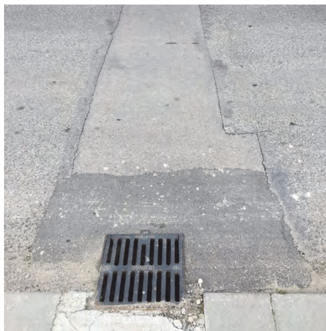
Sl. 5 Prikaz oštećenja saobraćajnice
