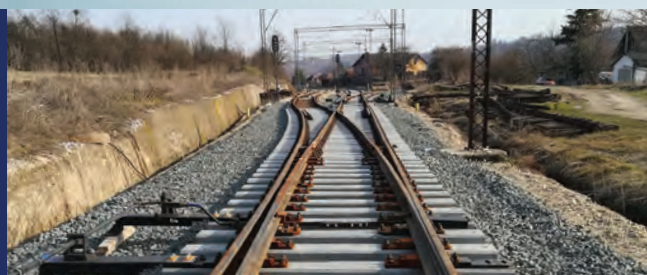
Projekat: Deonica pruge Jajinci-Mala Krsna-Velika Plana i železnička stanica "Mala Krsna" Usluga: Izvođenje građevinskih i elektro radova Investitor: "Infrastruktura železnice Srbije", Beograd
