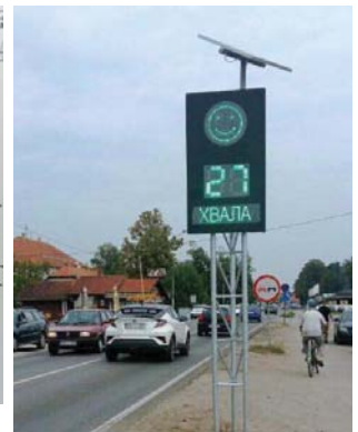
Postavljanje nestandardnog saobraćajnog znaka sa „LED“ treptaćima i elektronskog znaka sa izmjenljivim sadržajem poruka na magistralnom putu M18 u zoni Osnovne škole „Dvorovi“ u Dvorovima
