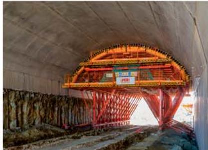
Primenom VARIOKIT VTC kolica za izradu oplata tunela Trbušani, omogućeno je izvođenje takta betoniranja od 15 m za svega šest radnih dana.
