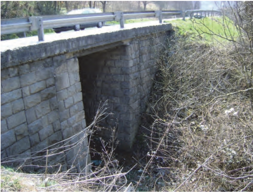
Slika 2. Postojeći propust na početku regulacije Seliškog potoka ispod magistralnog puta M1
