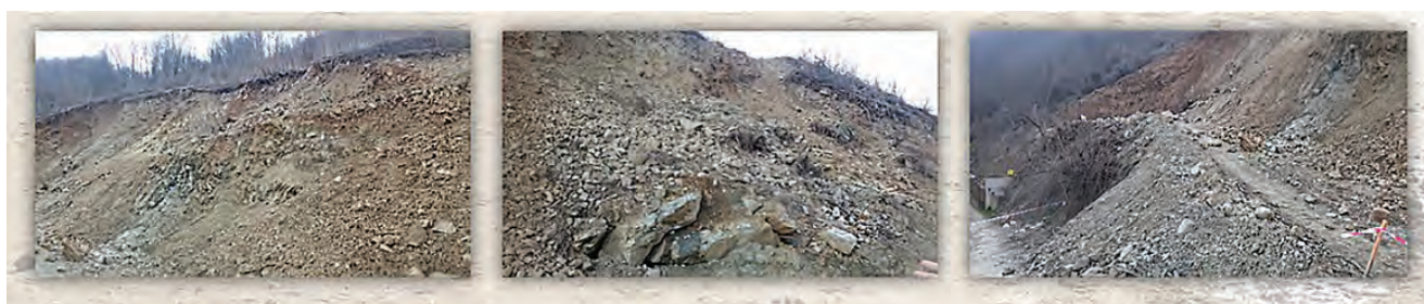
Sl. 5 Osulina na mestu izlaznog portala tunela Predejane na kojem su projektanti mislili da primene svoje rešenje - LOT 3
