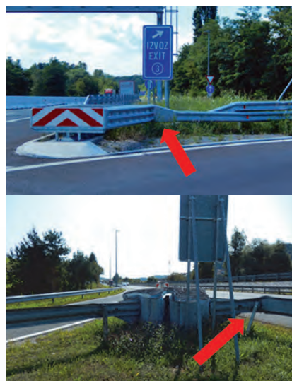
Slike 3 i 4: Linije bokova ublaživača i plašta zaštitne ograde imaju prevelik ugao, pa kod udara ublaživača dolazi do ugibanja i lomljenja plašta zaštitne ograde.
